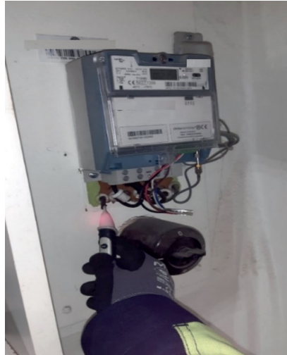
Spänningsförande utan säkringar.
