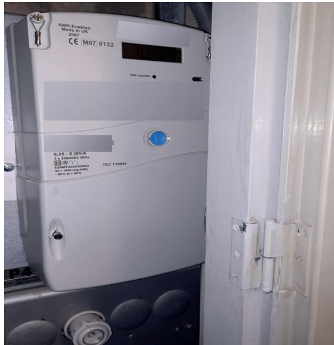
Inbyggd bakom en vägg.
