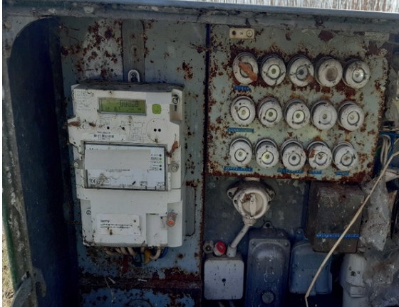
Anläggningar i dåligt skick.
